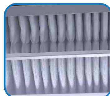
Exhaust Fan filter
